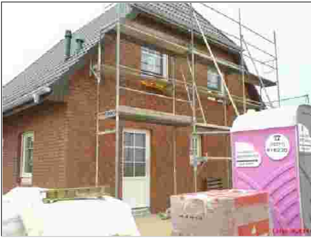
BauGberwachung, EFH verklindert, in Glienick
