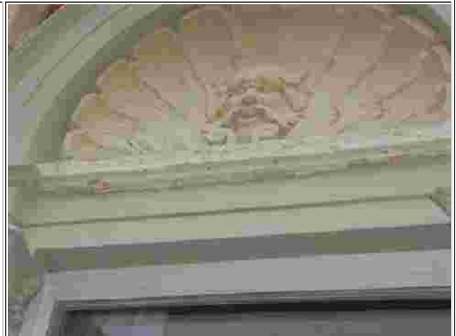
Putzmngel an GrGnderzeitvilla in der Eisenhardtstr.
